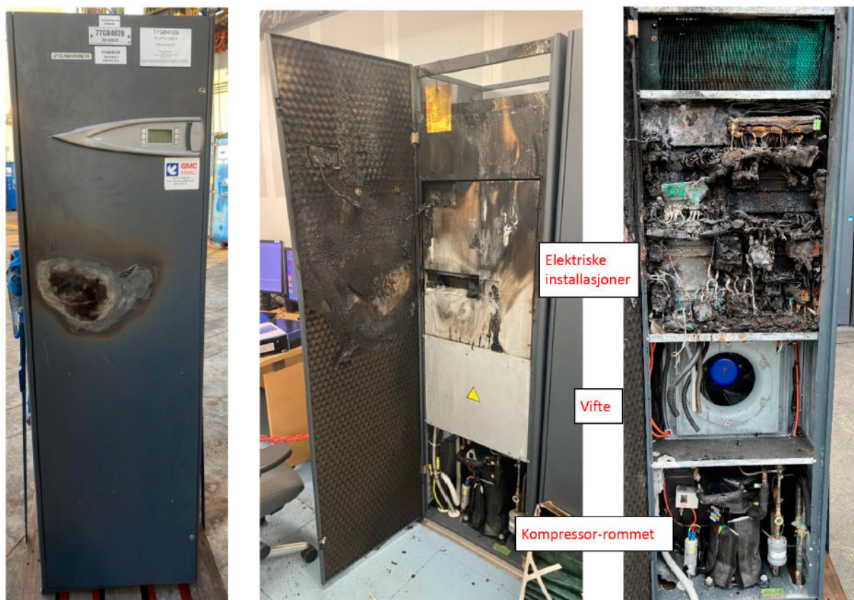
Figur 5 Kjøleenheten med kabinett døren lukket (til venstre), åpen (i midten), og etter at tre innvendige panelplater/deksler er fjernet (til høyre). (Kilde: SINTEF Rapport 2023-01109 Brann i DX-enhet på Gina Krog - Rev 1.0 (part 1))
